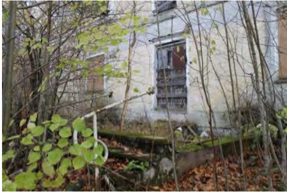
Pohjoiselle julkisivulle sijoittuneesta verannasta on jäljellä perustukset sekä metallikaiteet.
