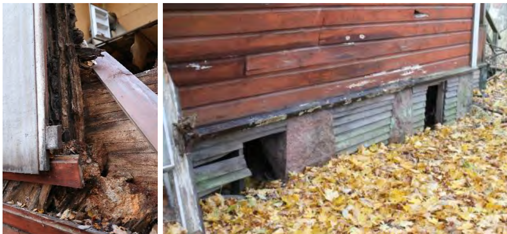
Romahtaneen julkisivu osalta (vasemmalla) oli näkyvissä rakennuksen seinärakenne. Rakennus on perustettu luonnonkivipilareiden varaan (oikealla).
