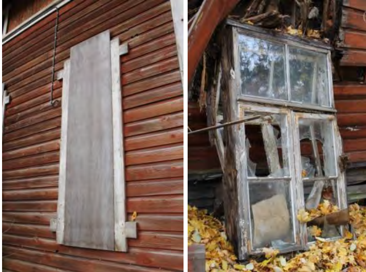
Rakennuksen kaikki ikkunat on peitetty. Takajulkisivu on osin romahtanut.
